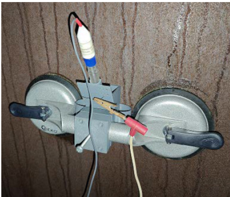
Obr. FV 21. Měření EIS charakteristik (řádového specifického odporu) na OP 1 (stojina/stěna) – první nosník (levá strana) – OSTRAVA SO 203
